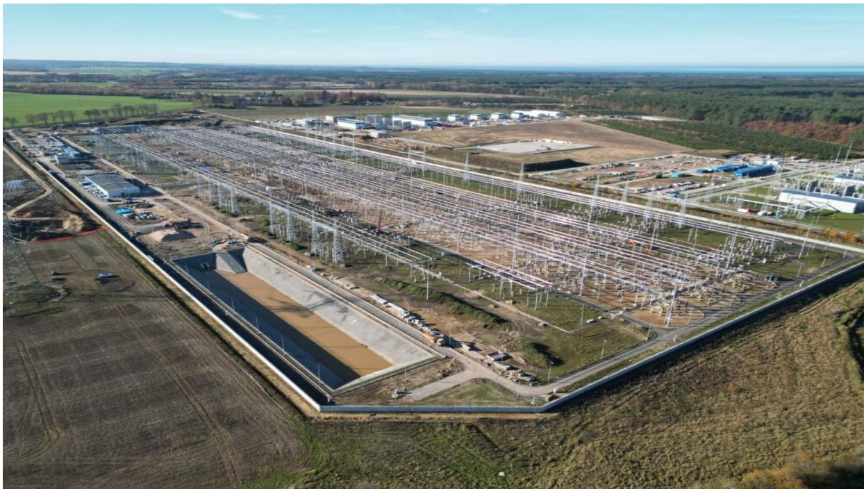
Rys. 3. Widok lądowych stacji abonenckich MFW i stacji PSE w Osiekach Lęborskich w gminie Choczewo (stan na stycznię 2025)
